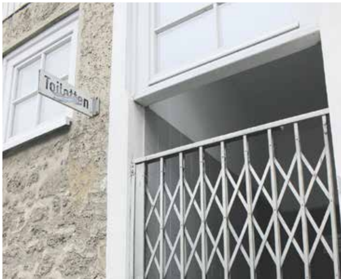
Die Toilette am Markt musste erneut aufgrund von Vandalismus gesperrt werden Fotos (3): Annika Steinkamp
