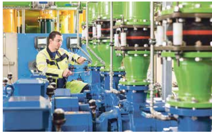
Rund um die Uhr im Einsatz, damit das Wasser aus dem heimischen Hahn fließen kann – die engagierten Fachkräfte der Wasserversorgung hier im Wasserwerk Fotos: Wasserverband Peine
