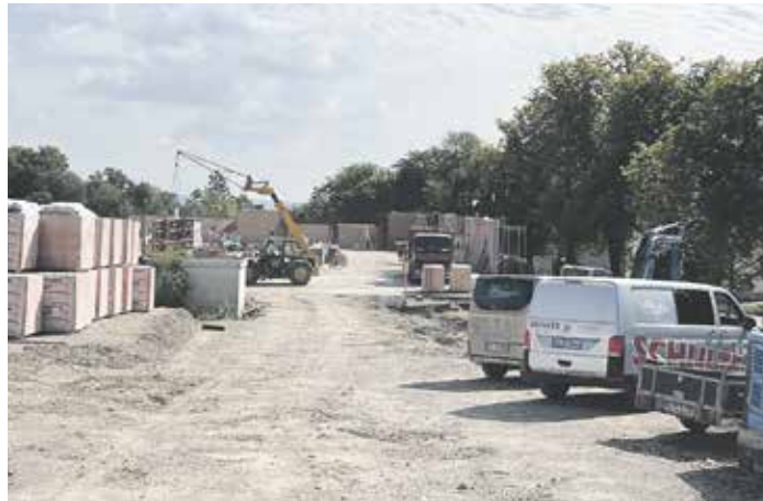
Nach zehn Jahren Stillstand wird wieder gebaut am Aldi-Markt an der Elmstraße. Die Baugenehmigung ist erteilt und rechtlich »erschöpfend geprüft« Foto: Michael Heinz
